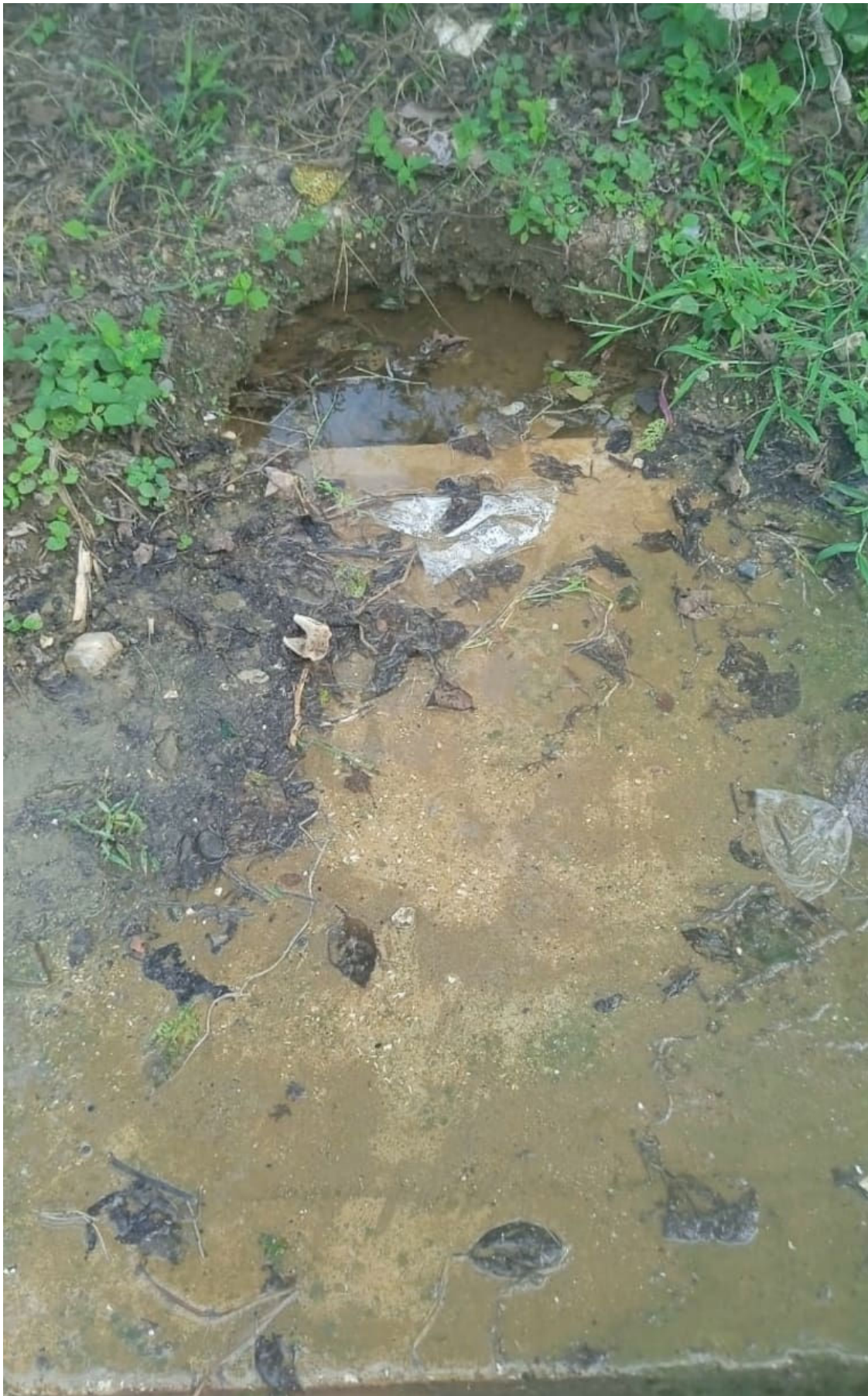
Manjoles deteriorados en Luruaco.
