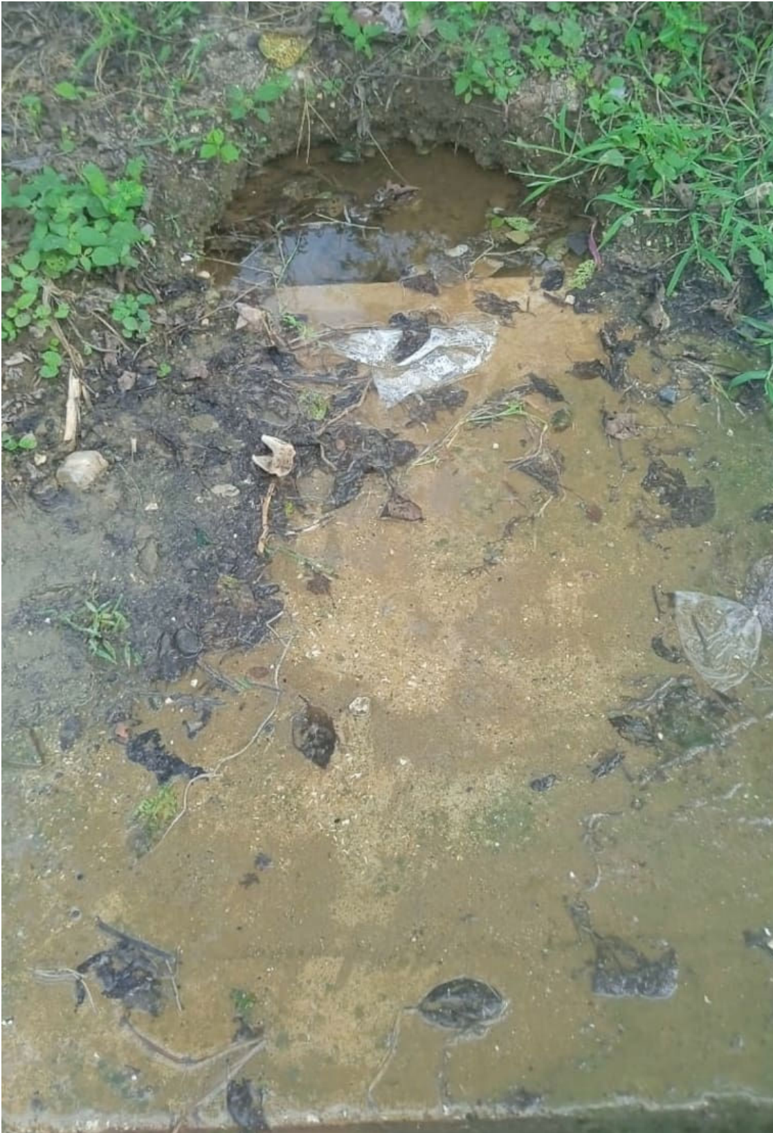
Manjoles deteriorados en Luruaco.
