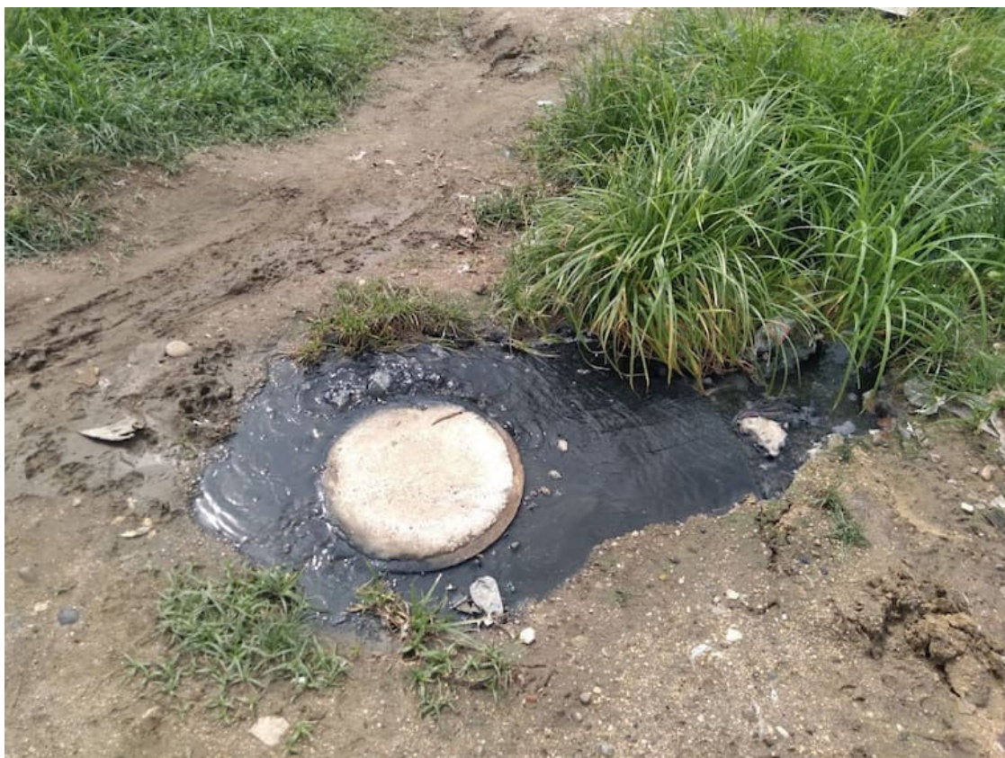
Manjoles rebosados de aguas residuales en el corregimiento La Peña.
